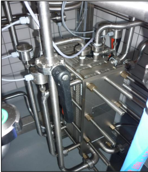
Plattenwärmetauscher / Foto Strickhof
